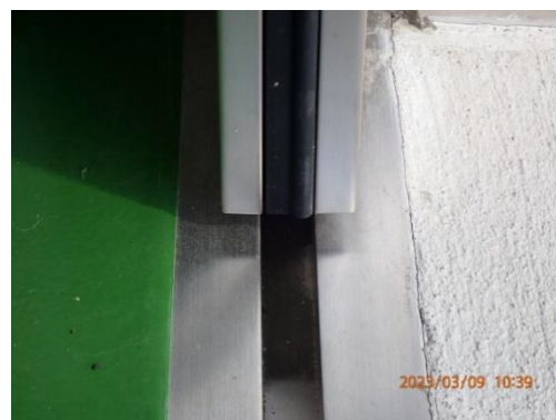
正常な方の扉、ガイドレールに対して正しい位置
