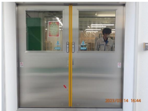
左の扉下の中央部、赤い線の下が凹み
