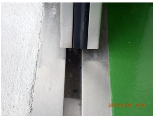
凹み、歪んだ扉、ガイドレールに対してズレている
