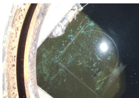
← 貯水槽底床 の汚れ
