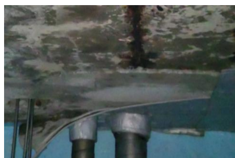
←天井部・コンクリートが剥離して錆び鉄筋が露出している
